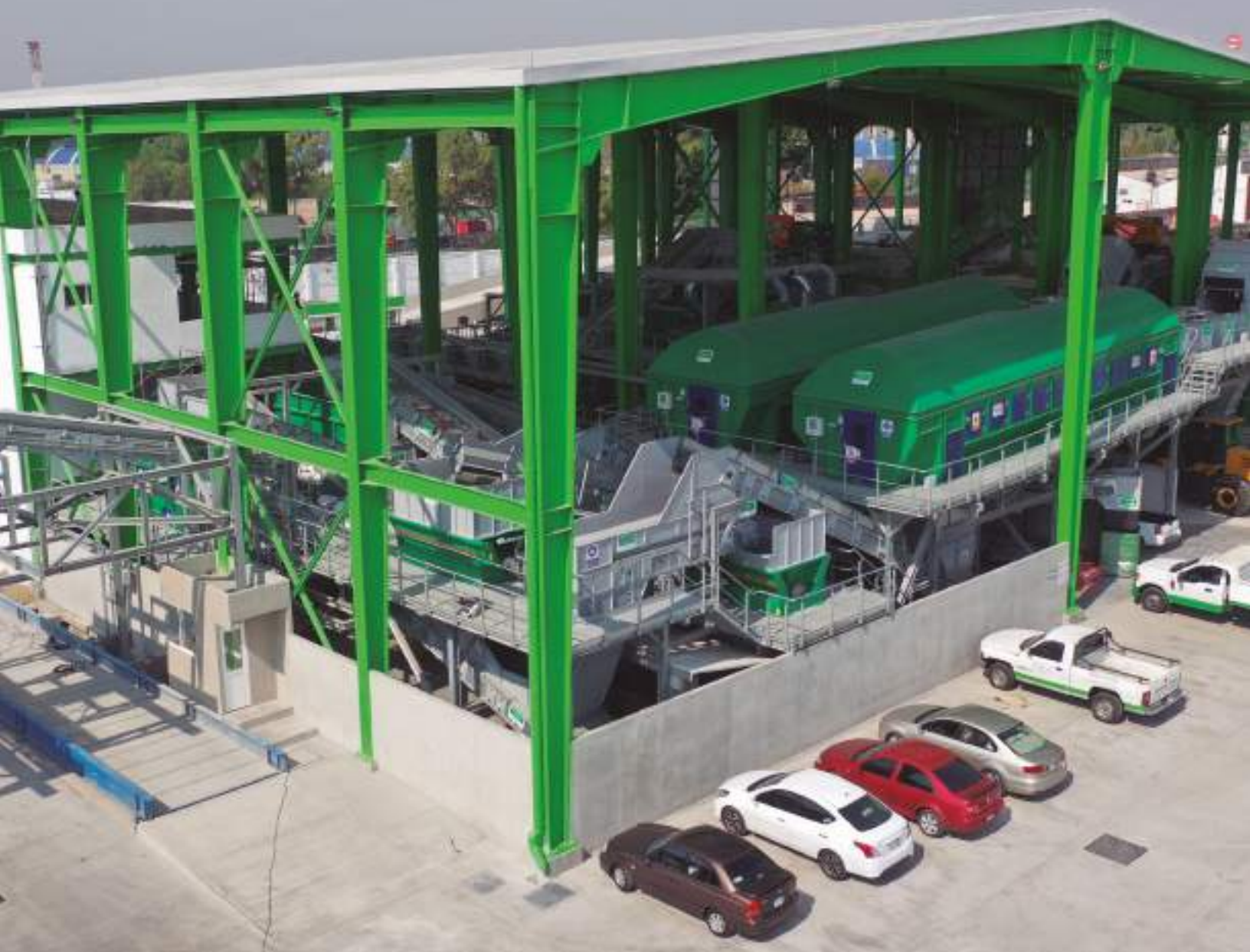
Instalación interior en la Planta de selección.
